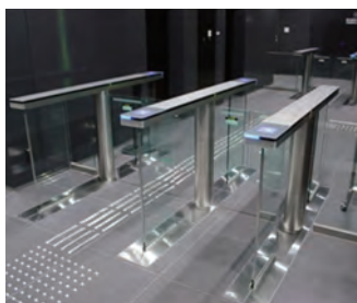
港南事業所のフラッパーゲート
