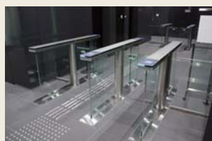
港南事業所のフラッパーゲート
