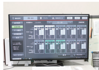
全機械の状況をモニターで一覧表示
